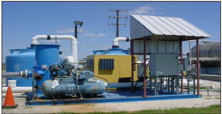
Un sistema de extracción de vapor en la tierra usado en la antigua base aérea Kelly.
